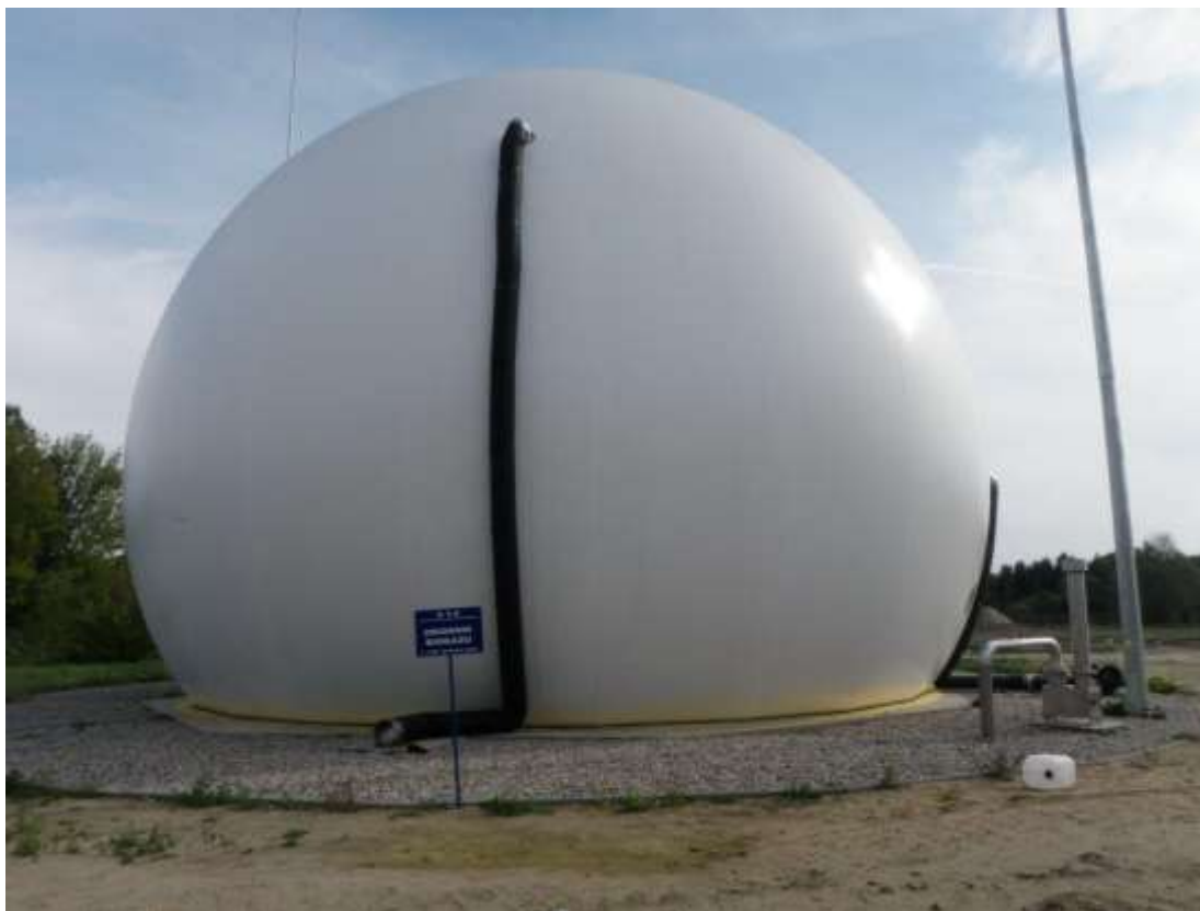
Fot.7.4. Stacja Termicznej Utylizacji Osadów Ściekowych ZWiK Sp. z o.o. w Ciechanowie (zbiornik biogazu)
