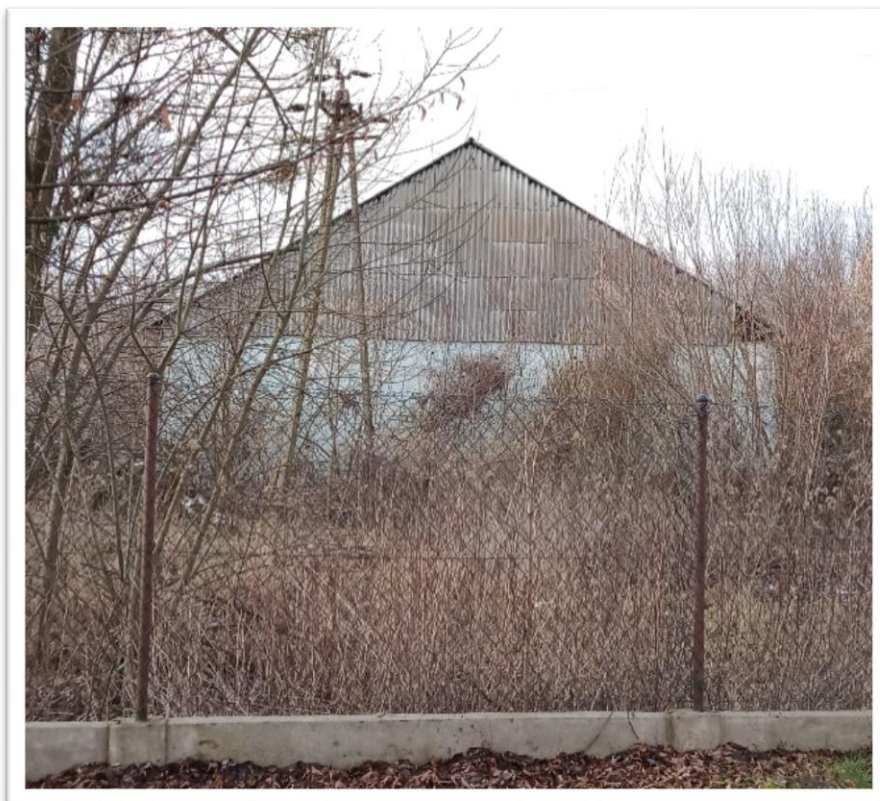
Rysunek 26 Budynek odznaczający się złym stanem technicznym zlokalizowany w Zdunowie na działce nr 22/15 Źródło: materiały z wizji lokalnej przeprowadzonej w dniu 31.01.2023 r.
