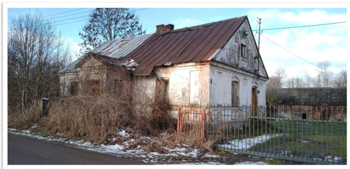
Rysunek 22 Budynek w złym stanie technicznym zlokalizowany w miejscowości Słotwin Źródło: materiały z wizji lokalnej przeprowadzonej w dniu 31.01.2023 r.
