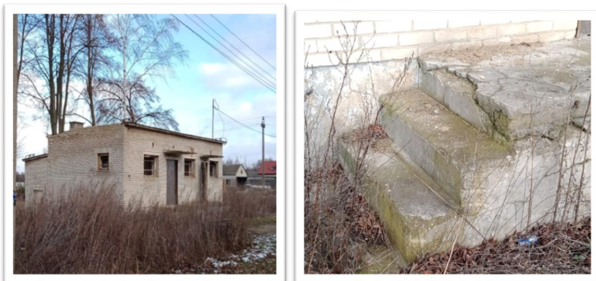
Rysunek 23 Przykład budynku odznaczającego się złym stanem technicznym – Michałówek dz. Nr 41 Źródło: materiały z wizji lokalnej przeprowadzonej w dniu 31.01.2023 r.
