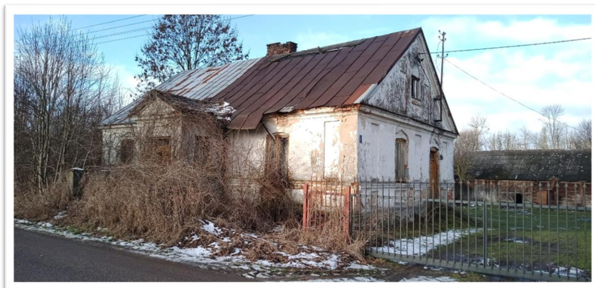
Rysunek 22 Budynek w złym stanie technicznym zlokalizowany w miejscowości Słotwin Źródło: materiały z wizji lokalnej przeprowadzonej w dniu 31.01.2023 r.
